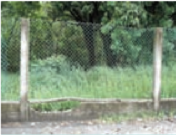
Barda perimetral en mal estado, antes de los trabajos del PET.
