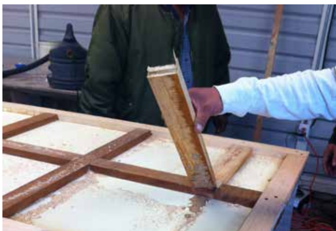
▲ Eliminación de travesaño atacado. CNCPC | © INAH, 2015.
